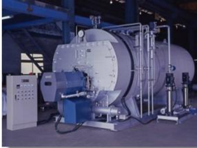
備註：臥型煙管式鍋爐
